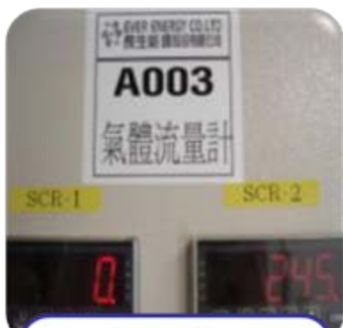
防制設備之廢 氣入口端裝設 流量計
