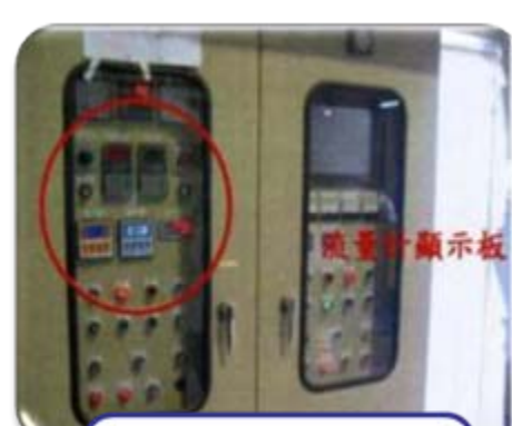
洗滌設備裝設 液體流量計
