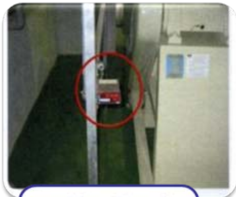
防制設備之廢 氣入口端裝設 流量計
