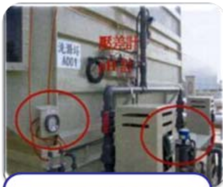
洗滌設備(處理VOC 污染物及磷酸)-裝 設pH計及壓基計
